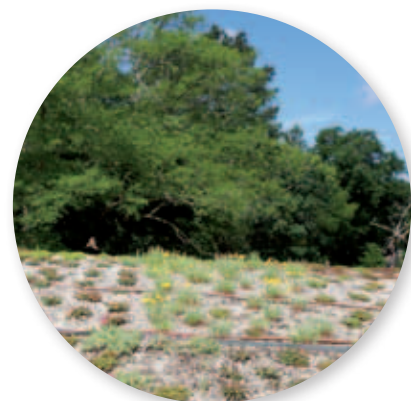
Le toit végétalisé offre une excellente isolation thermique
